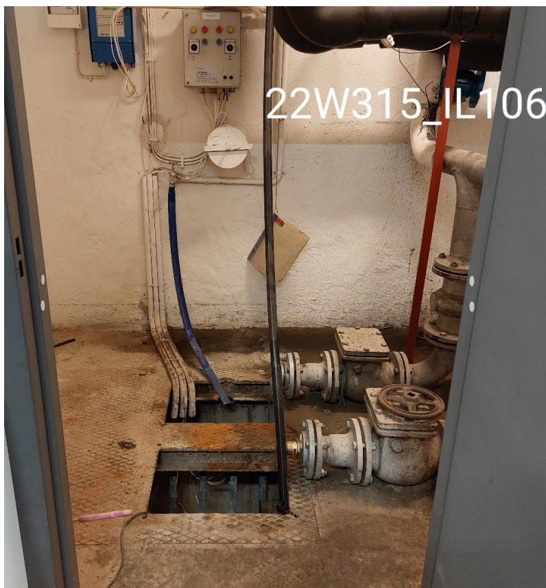
Figur 7. Pumprum med hål ned till pumpgröpp på källarplan i Hus 315. Utöver vatten provtogs luft i pumpgröppen ovan vattenytan (22W315_IL106, vars beteckning syns i bilden).
